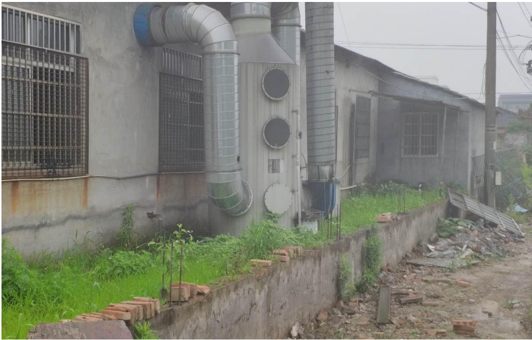
废气处理设施
