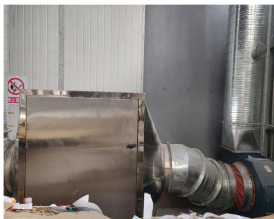
一级活性炭吸附处理、排放
