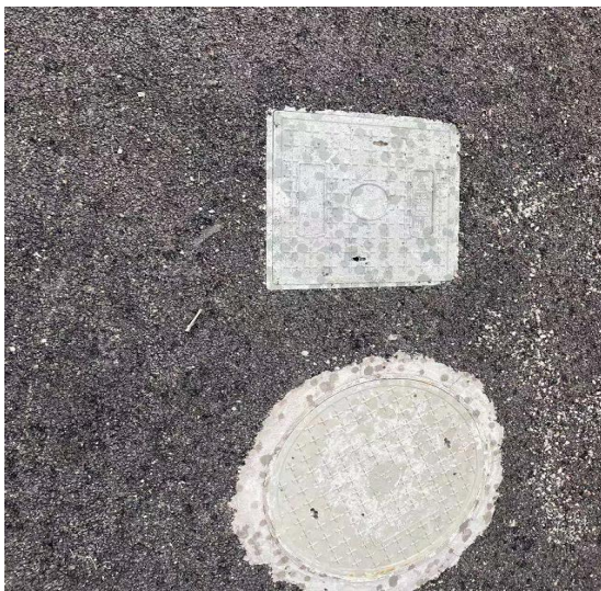
地埋式污水池
