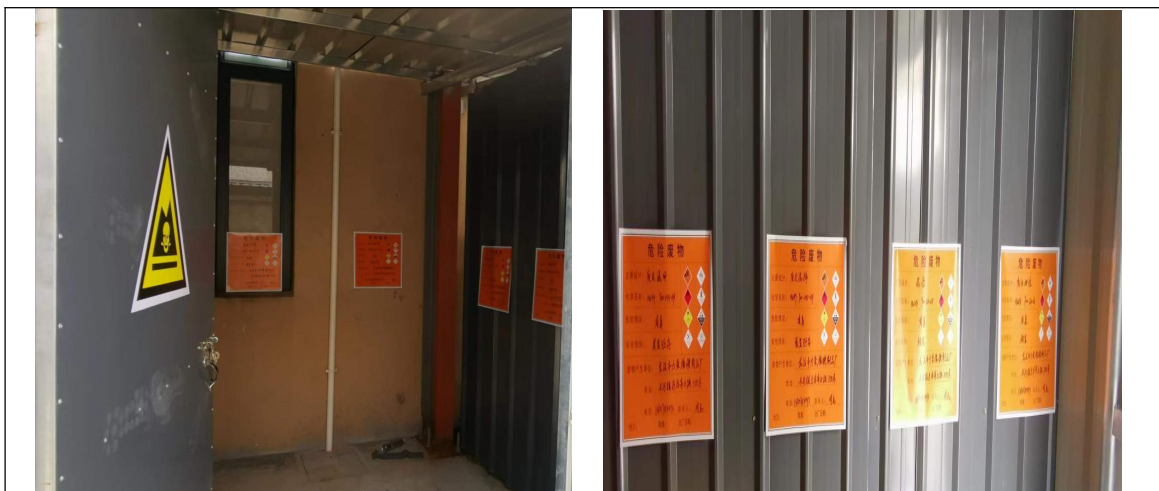
危废暂存间及危废标识
