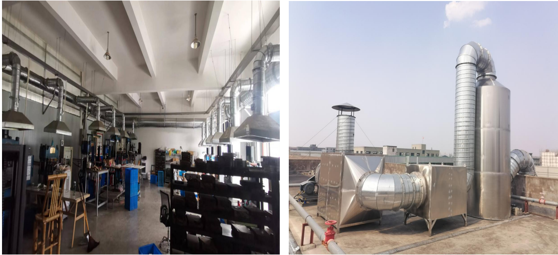
成型废气、熟化废气收集、处理、排放（1根）
